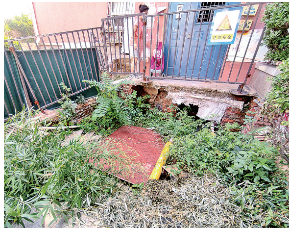
■ 登州路39号12号楼1单元的电梯基坑北侧护栏倒塌,坑内长满杂草。
