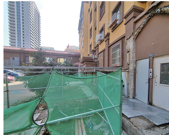
■ 于家下河社区5号楼2单元门前的电梯基坑周围防护不到位。
