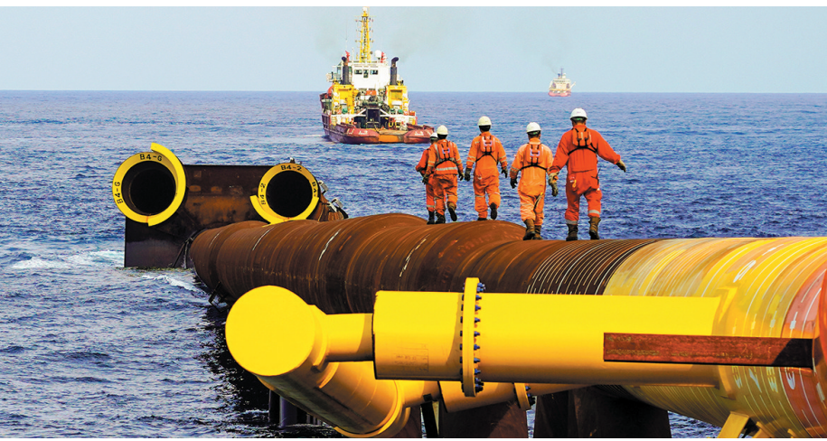
■陆丰12-3深水导管架在南海东部海域成功滑移下水并精准就位。
