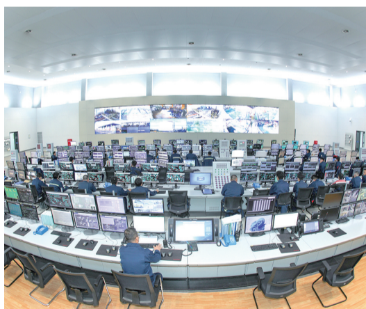
海湾化学中央控制室。
