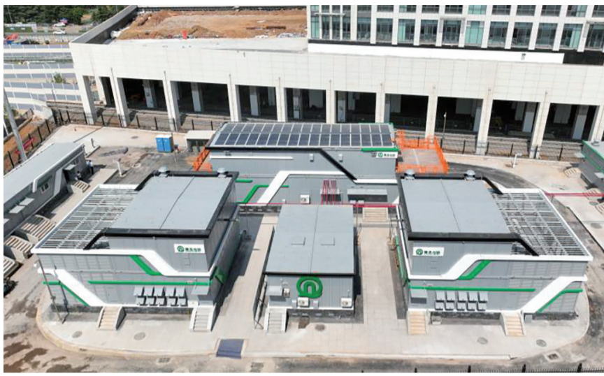
装配式主变电所。 青岛地铁供图
