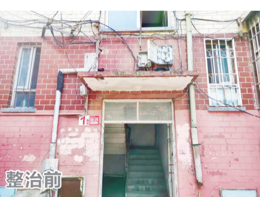
胶州市供电公司宿舍“飞线”整治前。
