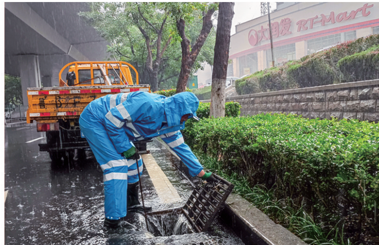
青岛水务“排水人”在一线疏通排水。青岛水务排水公司供图
