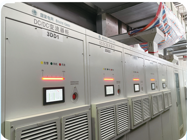
薛家岛充换电站内的设备。
