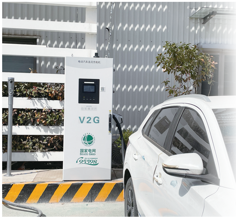
新能源车主通过这台V2G充电桩将电卖给电网。
