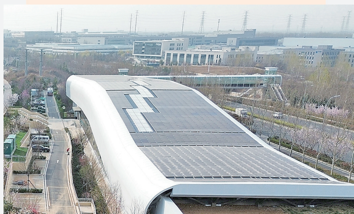
地铁6号线横云山路站的光伏系统。
