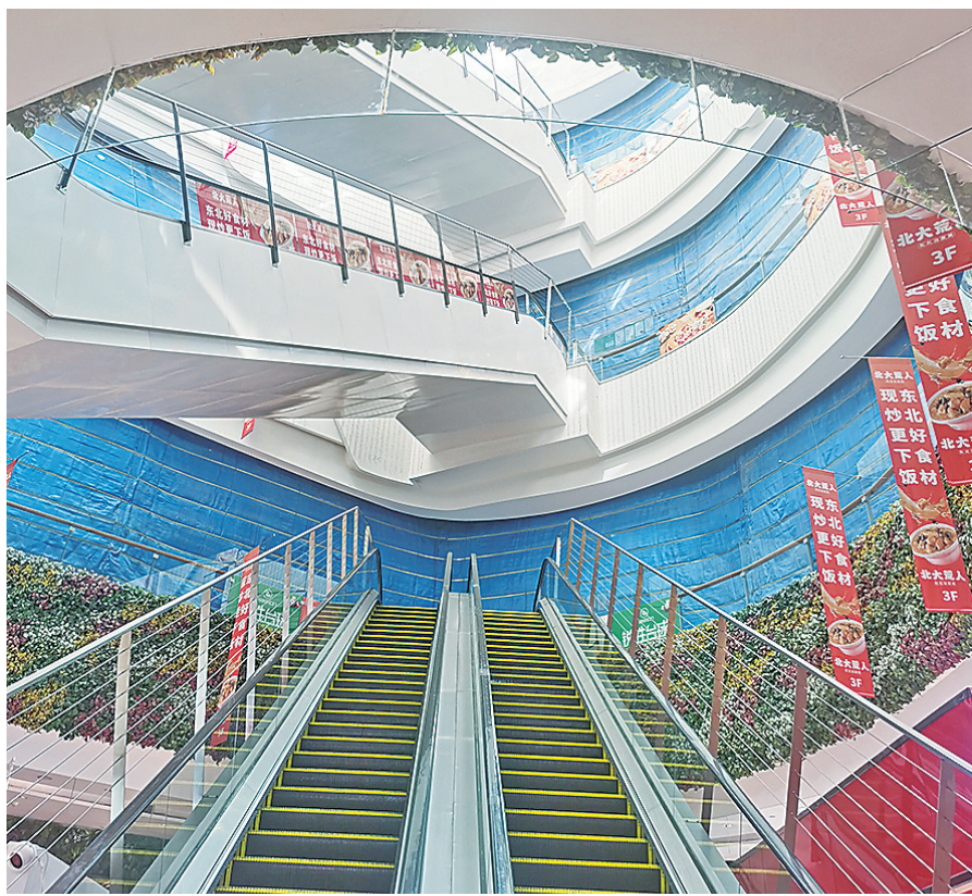
■卓悦里·intown大部分商业空间已经设置围挡，开始装修。余瑞新 摄
