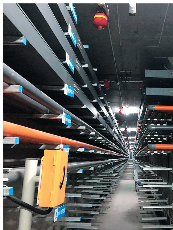
■图为已投用的青岛西海岸新区贡北路地下综合管廊通信舱。
