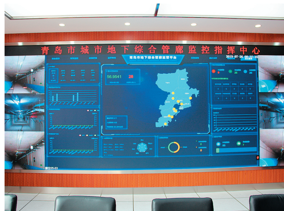
■图为青岛市级地下综合管廊监管平台，这里是管理综合管廊的“大脑”，可以远程监测和控制舱内设备。王冰洁 摄
