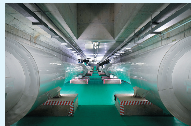
■青岛胶东国际机场地下综合管廊热力舱。刘栋 摄
