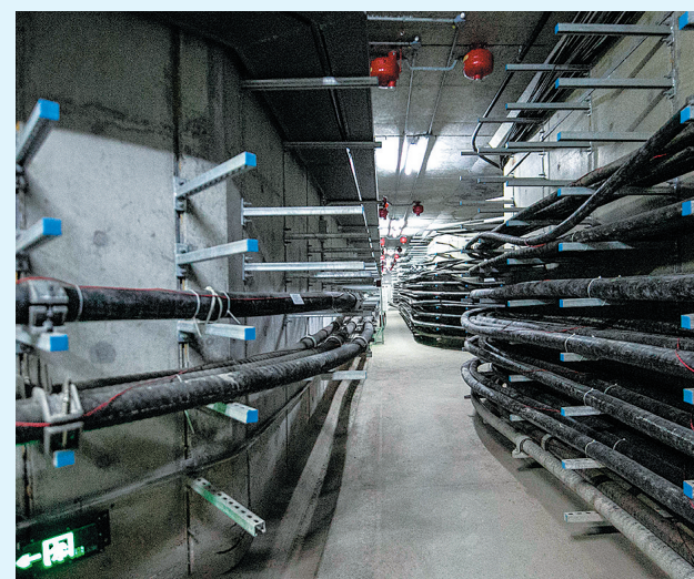
■青岛胶东国际机场地下综合管廊内布设多层支架，各类线缆依托支架“各行其道”。刘栋 摄
